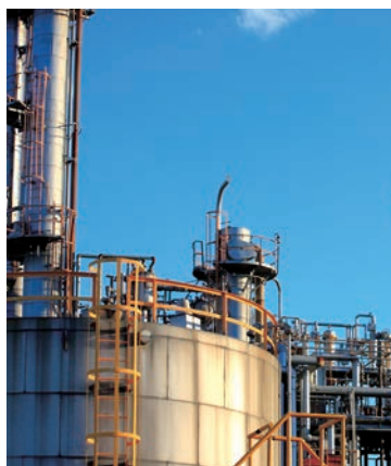
石油、ガス精製プラント
